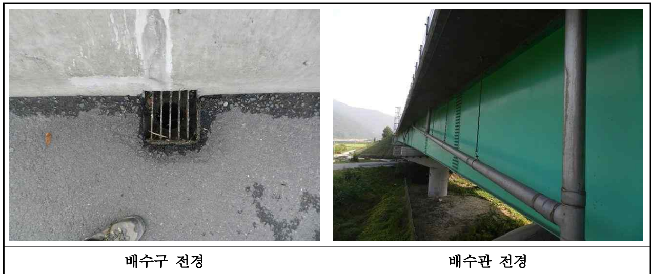
【사진 3.3.16】 배수구 및 배수관 전경(부산)
