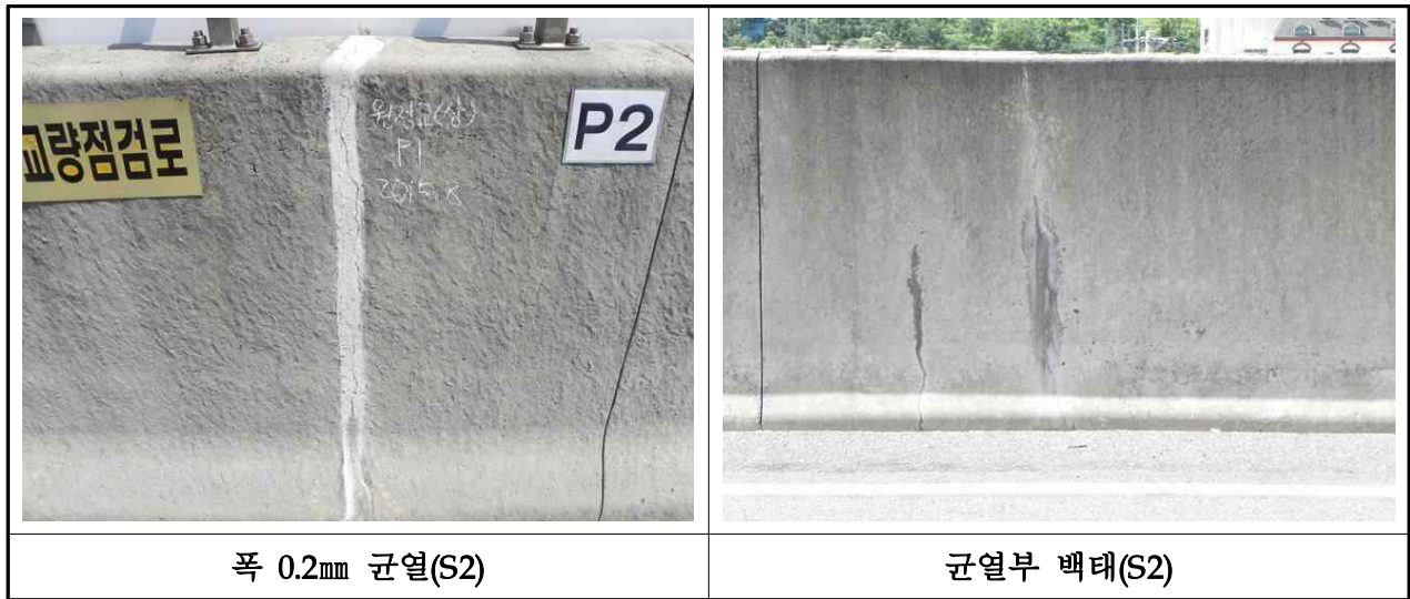
【사진 3.2.18】 난간 및 연석 손상현황(대구)
