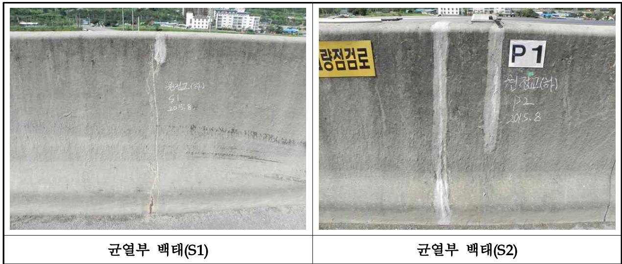
【사진 3.3.18】 난간 및 연석 손상현황(부산)
