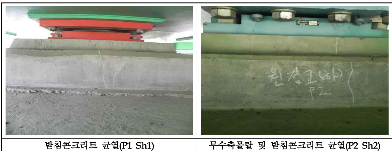
【사진 3.3.9】 교량받침 손상현황(부산)
