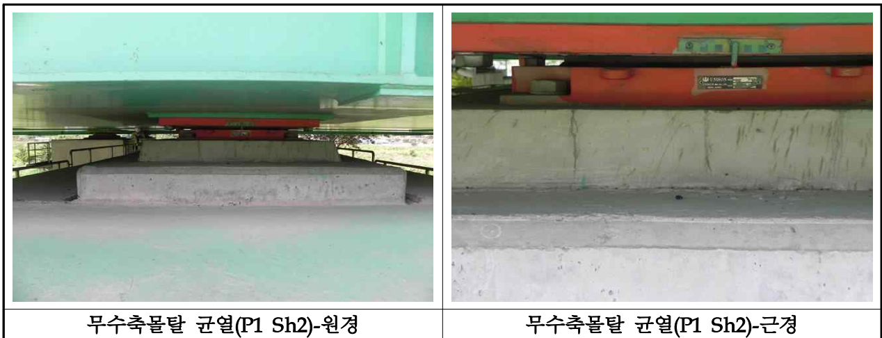
【사진 3.2.9】 교량받침 손상현황(대구)
